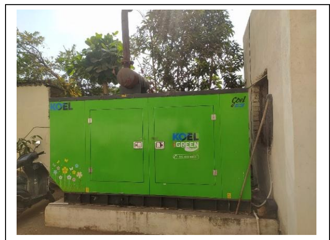
125 KVA DG set
